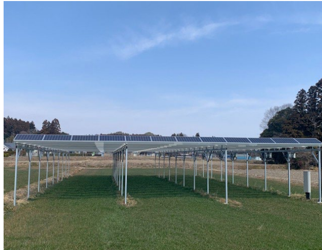
▲ 太陽光発電設備
